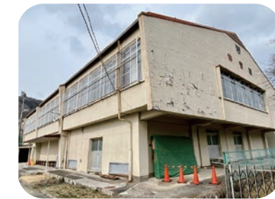
老朽化した坂上体育館
