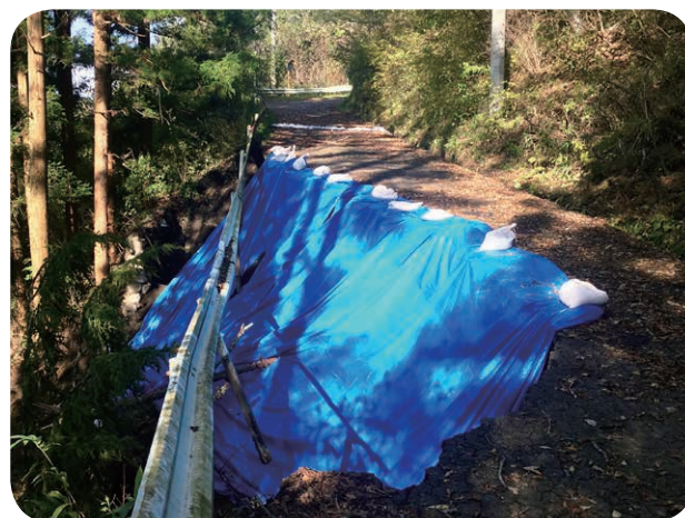
台風19号の被害を受けた町道 本宿・萩生線(当時)
