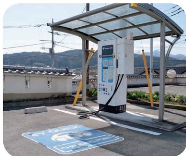
役場前のEV用充電器
