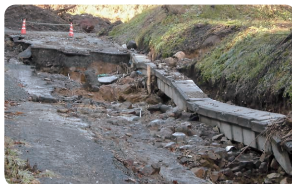
台風19号により洗掘された道路
