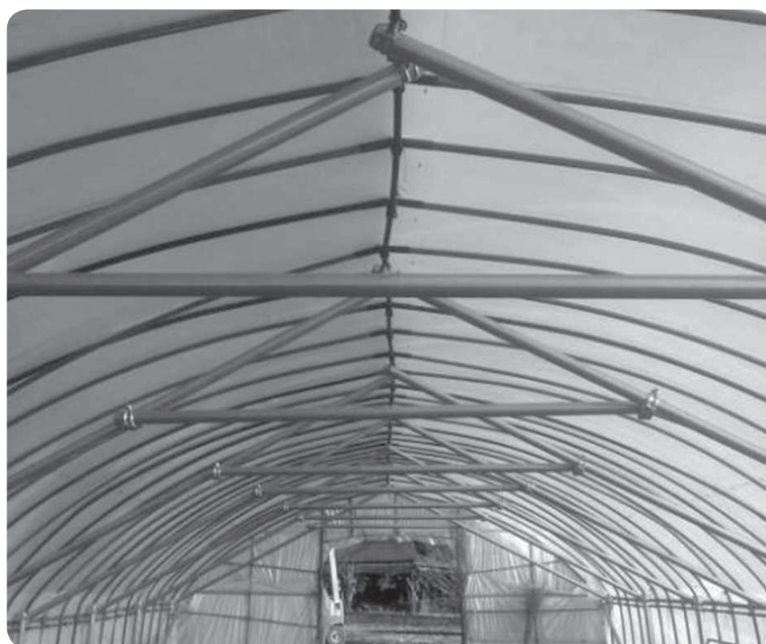
雪害対策として耐雪補強を行ったビニールハウス
