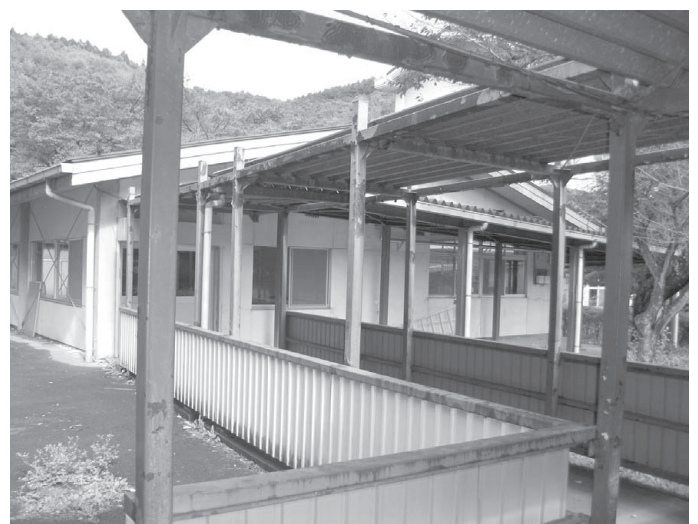
施設修繕が課題となっている給食調理場
