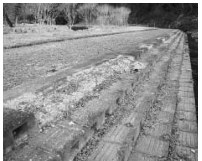
損傷の目立つコンクリートブロック (岩井親水公園)
