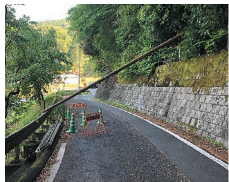
▲ 道路脇で樹木が枯れ倒れたケース
