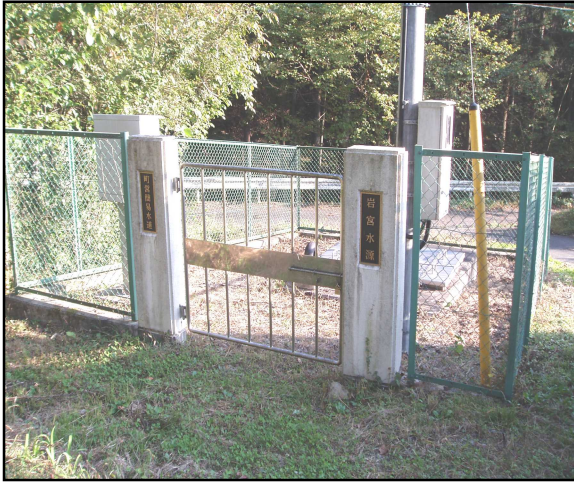
取水ポンプ場
