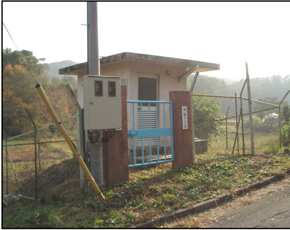
送水ポンプ室
