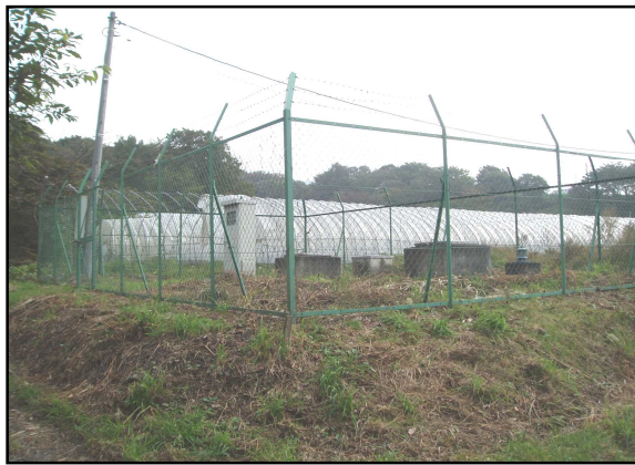
取水ポンプ場
