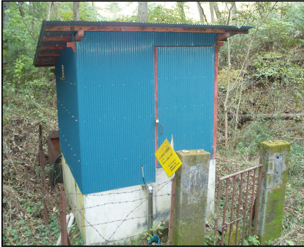
導水ポンプ室
