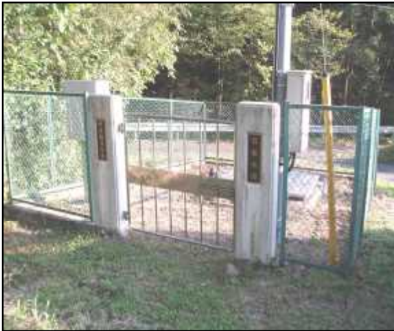
取水ポンプ場
