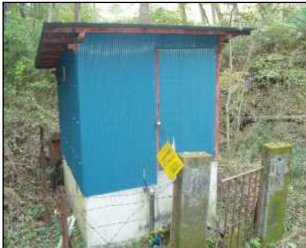
導水ポンプ室
