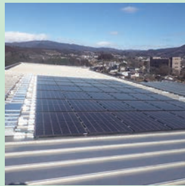
東吾妻中学校に設置された太陽光発電システム
